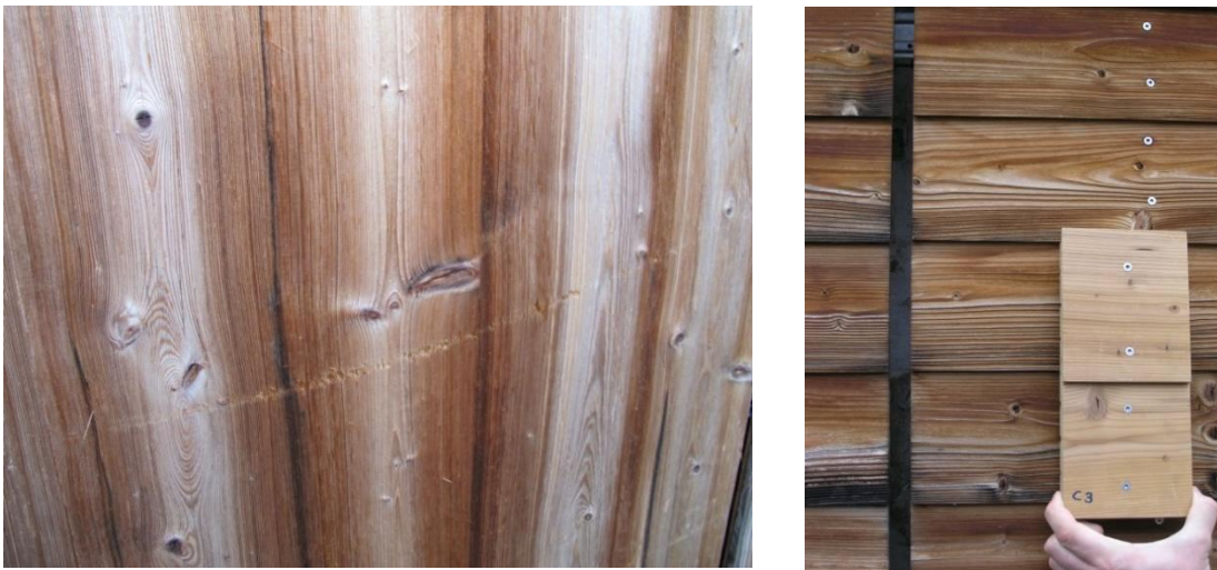
Abbildung 2: Fi-Thermoholz 3-Schichtplatte und Stülp-schalung nach 8 Jahren Bewitterung
