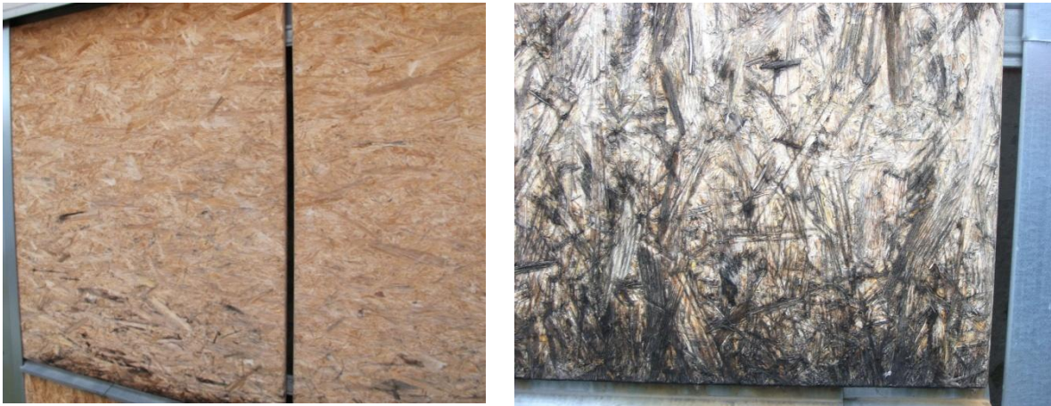
Abbildung 4: OSB3 Platte nach 8 Jahren Bewitterung (li Gesamtansicht, re Spritzwasserbereich)
